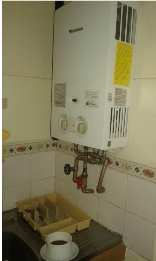
Calefont en Cocina
