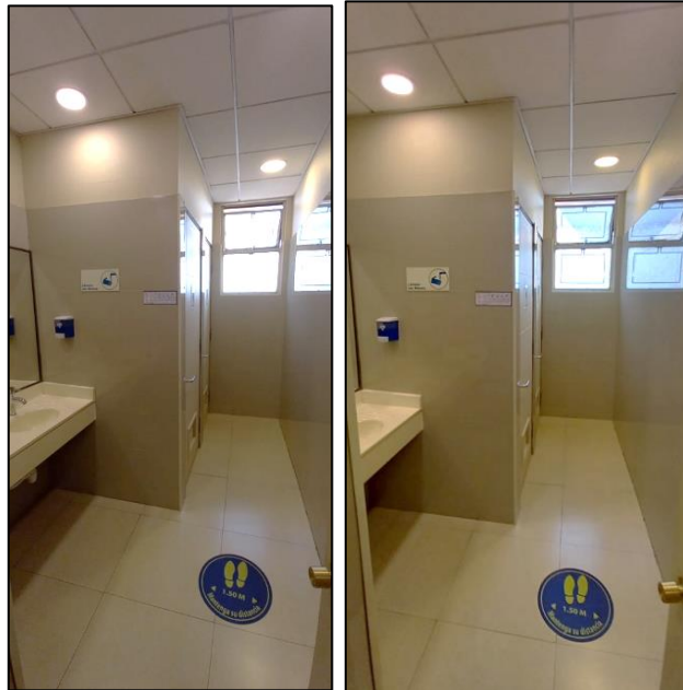
Situación actual baño piso 6
