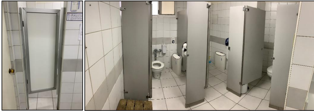
Imagen N°1: Referencia puertas a retirar.
