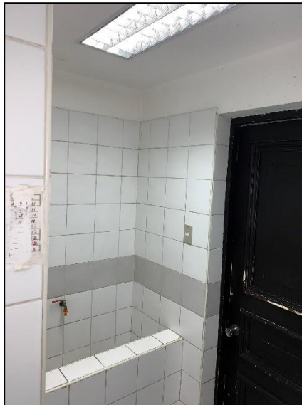
Imagen N°4: Fotografía lavatorio existente.
